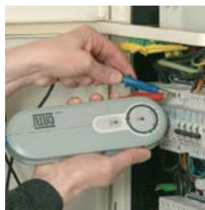
DT-500 sur installation consignée hors tension
