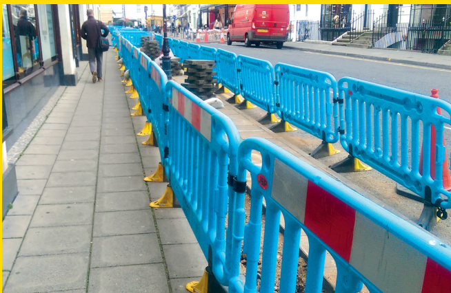
Alignement de barrières Frontier® bleues reliées les unes aux autres avec pieds anti-trébuchement.
