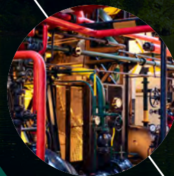
CIMENTERIE CHAUDIÈRE INDUSTRIELLE Cement - Gaz fumace
